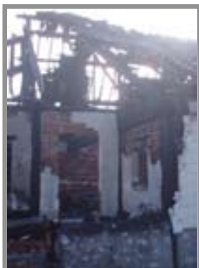
La cage d'escalier après l'incendie...
